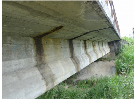
35.PC桁の鉄筋が腐食しだしているぞ
